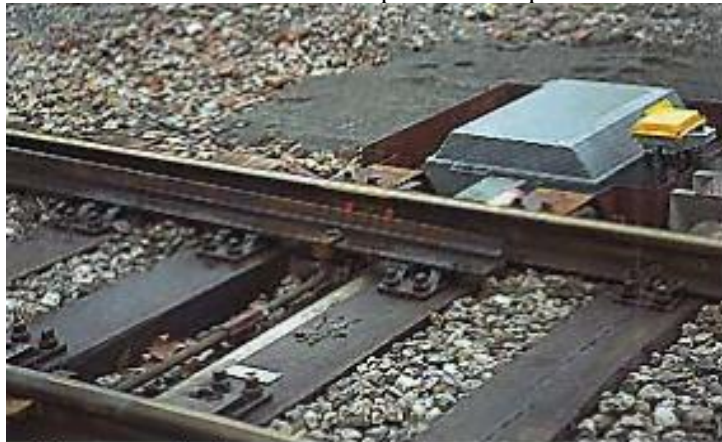
Slika 7. Skretnica s električnom postavnom spravom
